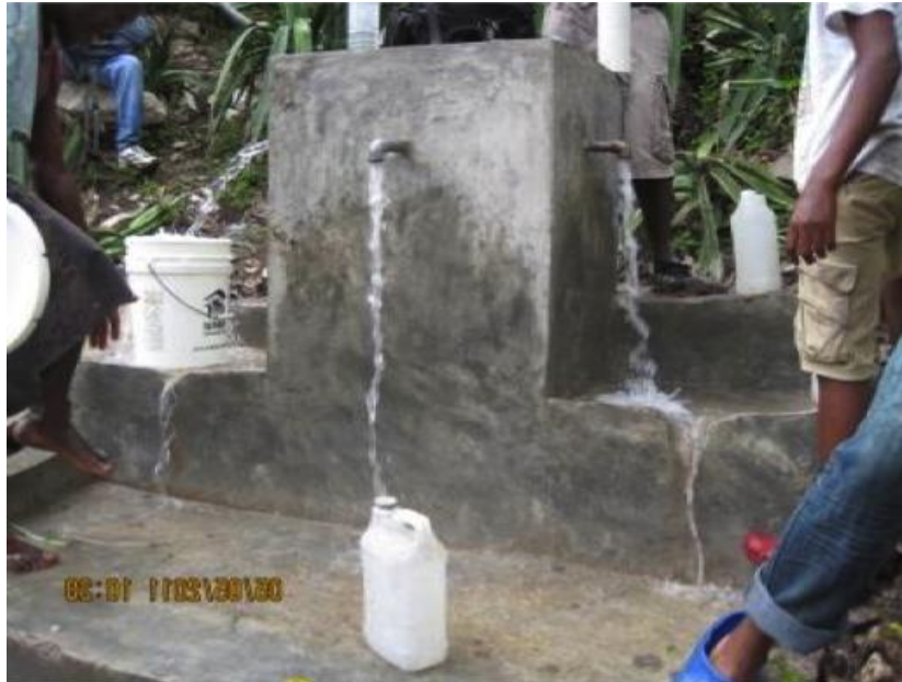
PHOTO 3: CAPTAGE TI-CORAY A COTE DE FER
